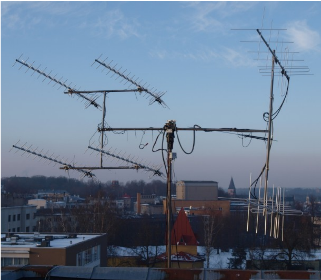
Joonis 9. Paigaldatud antennisüsteem.
